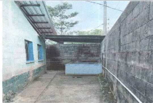
Foto 8: Sustitucion de lamina por lamina troquelada aluzinc calibre 26 y Sustitucion de estructura de soporte de madera por metal
